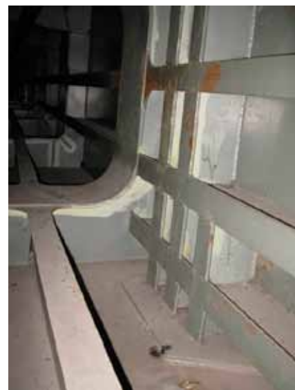
Fot. 5. Strefa wzmocnienia wyboeczonej, pionowej ścianki dźwigara skrzynkowego
