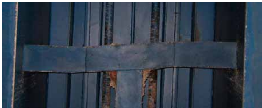
Fot. 6. Widok od dołu na poprzecnicę przęsłową o zaburzonej geometrii będącej konsekwencją błędów na etapie wytworzenia i montażu konstrukcji
