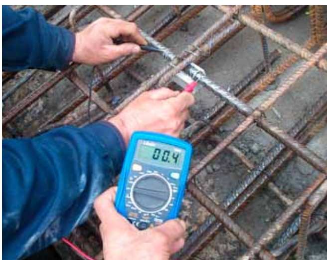
Pomiar rezystancji po podłączeniu protektora (2015 r.)
