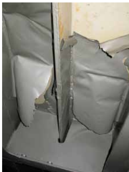
Fot. 4. Wadliwie odtworzenie powłoki antykorozyjnej w ramach bieżącego utrzymania
